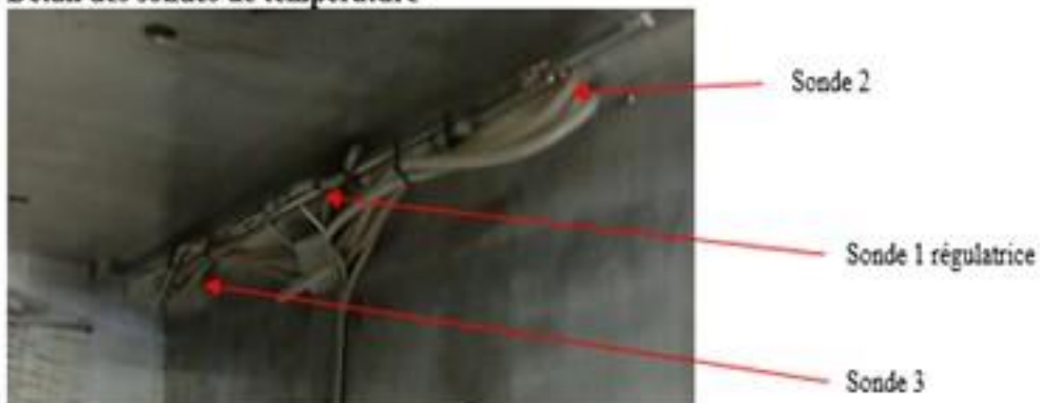
Détail des sondes de température
